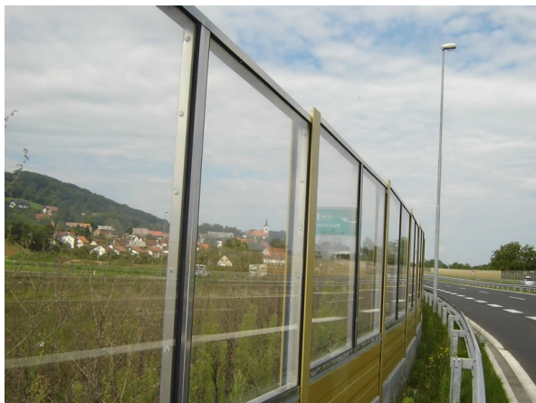
Slika 11: Akrilna protihrupna ograja debeline 15 mm na dolnji avtocesti v bližini Čadeža ob Savi [8].
